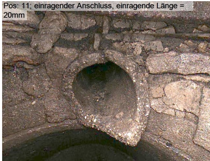
Schacht HO37 - Kirchenweg
