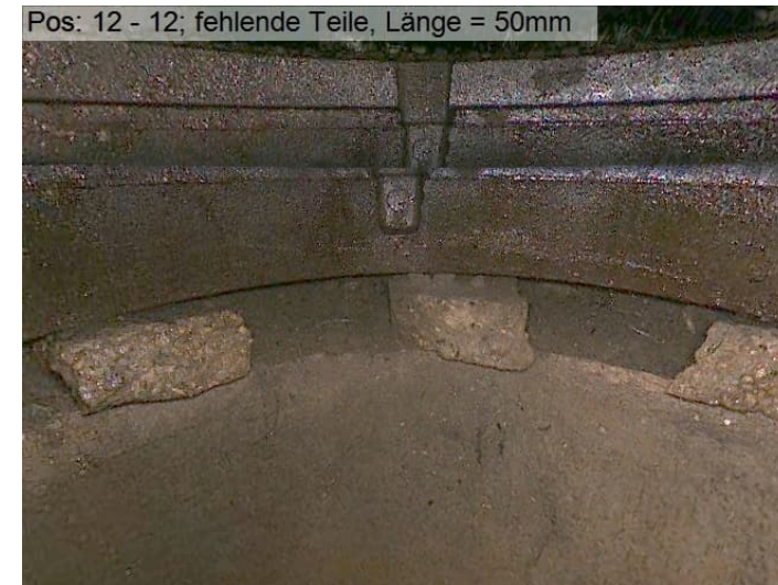
Schacht HO62 - Untere Zeil
